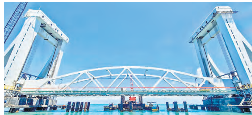
पंवन पुल वैश्विक मंच पर भारतीय इंजीनियरिंग की उल्लेखनीय उपलब्धि के रूप में खड़ा है। यह पुल 2.5 किमी से अधिक लंबा है। पुल का निर्माण करने वाले सार्वजनिक क्षेत्र के उद्यम रेल विकास निगम लिमिटेड (आरवीएनएल) के निदेशक
