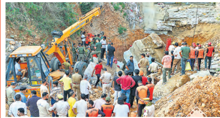
जम्मू शहर के बाहरी क्षेत्र बंतालाब में शुक्रवार को एक छोटे पुल का एक हिस्सा ढहने से तीन-चार मजदूर मरने के नीचे दब गए जबकि एक घायल मजदूर को बाहर निकाल लिया गया। पुलिस, सेना और राज्य आपदा मोचन बल (एसडीआरएफ) की टीम ने मलबे के नीचे दबे लोगों को निकालने के लिए बचाव अभियान चलाया। फोटो में निर्माणधीन पुल के ढह जाने के बाद वहां बचाव अभियान में जुटे बचावकर्मी।
